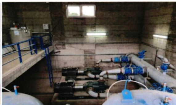
Сл 5. Пумпна станица
